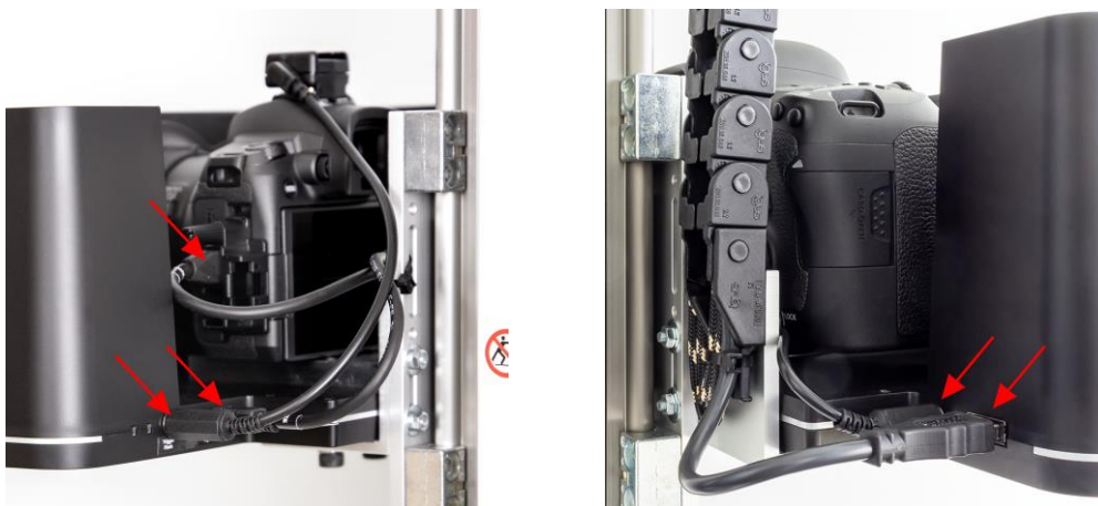
Bilde 5: Kabeltilkoblinger for PolFlash XE og kamera til ATBM-tårn (sett fra venstre og høyre)
